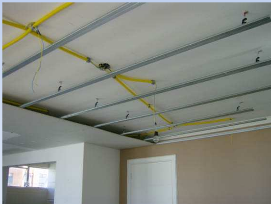
Forro de Gesso Acartonado
