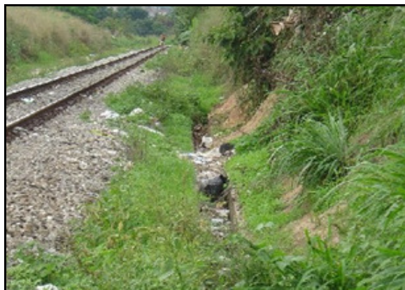
FIG. 5.8: Canaleta obstruída FONTE: FCA (2007, b)
