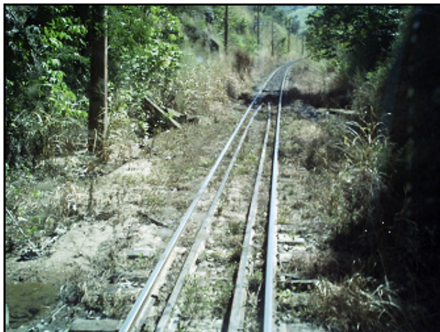
FIG. 5.7: Vegetação ao longo da via (Lastro Colmatado) FONTE: FCA (2007, b)
