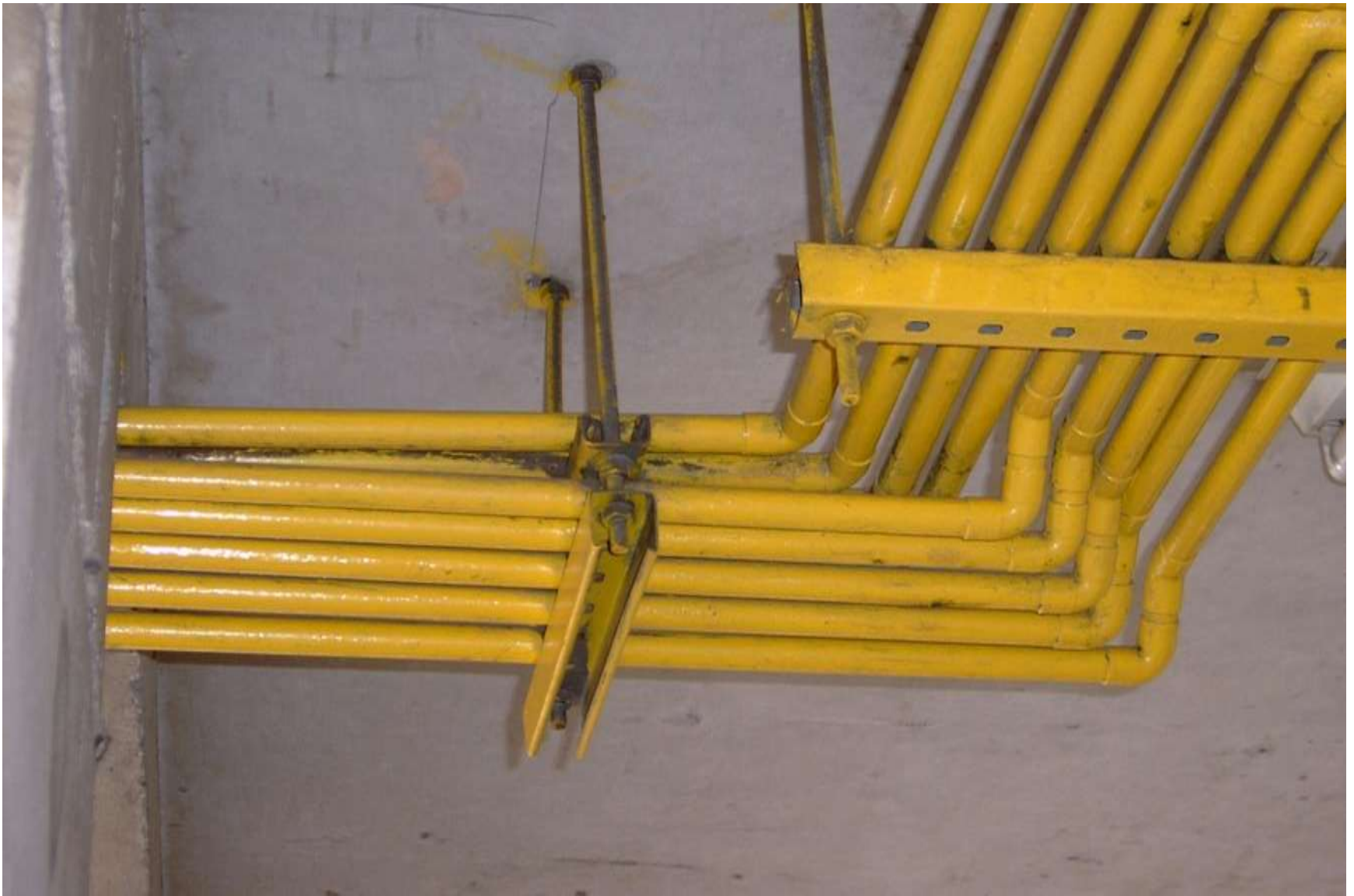
Detalhes da tubulação de gás
