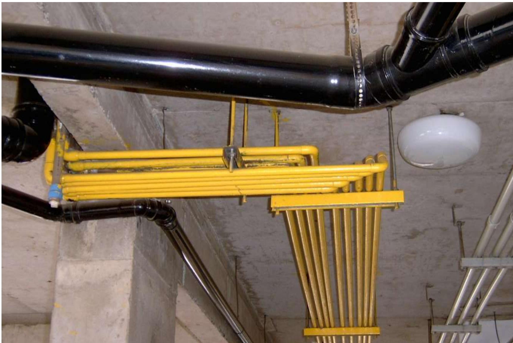
Detalhes da tubulação de gás (amarela)
