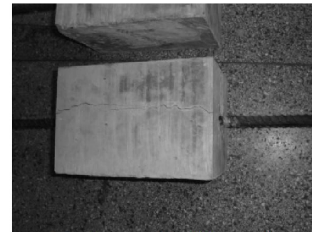
Ruptura por fendilhamento
