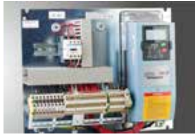
Conversor de frequência para «eivar» e para «movimentos de carros e de pontes móveis»
