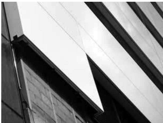
Figura 6.3 – Painéis de ACM instalados em fachada de edifício comercial com vedação convencional de alvenaria. (Acervo INOVATEC CONSULTORES)
