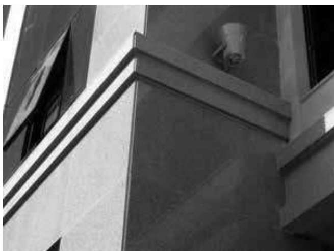
Figura 6.8 – Revestimento em granito instalado com insertos metálicos em fachada de edifício comercial. (Acervo INOVATEC CONSULTORES)
