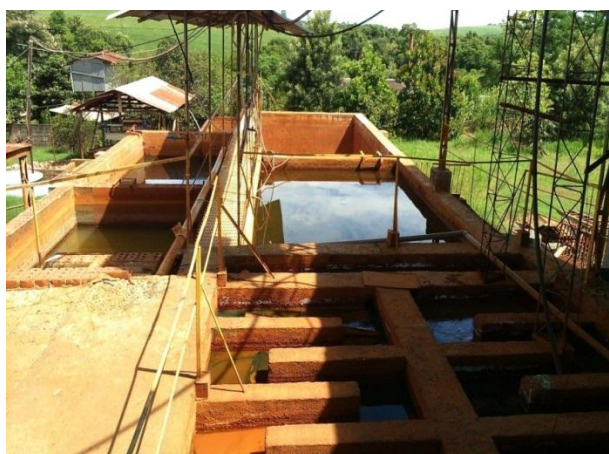
Figura - 17 Estação de tratamento atual
