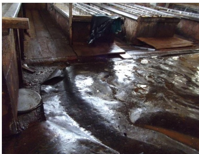
Figura 2 Piso precário e tanques antigos de metal
