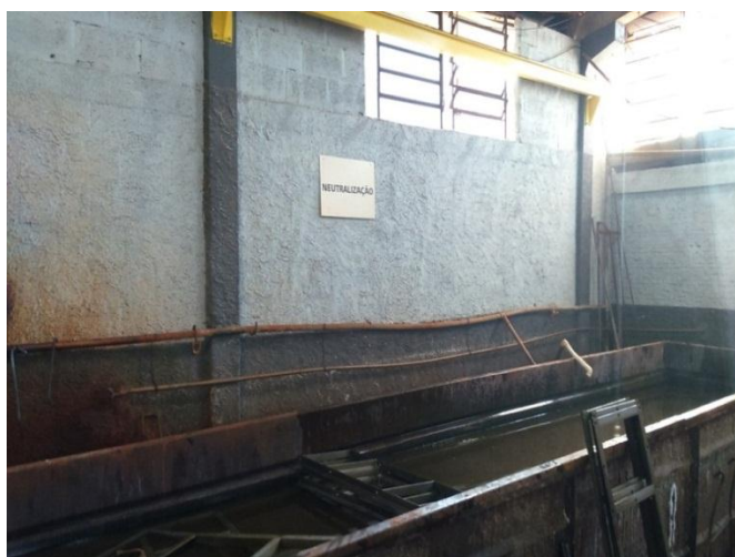
Figura - 7 Tanque de neutralização
