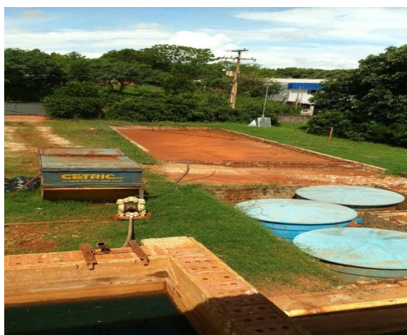
Figura - 18 Tanques de tratamento dos resíduos
