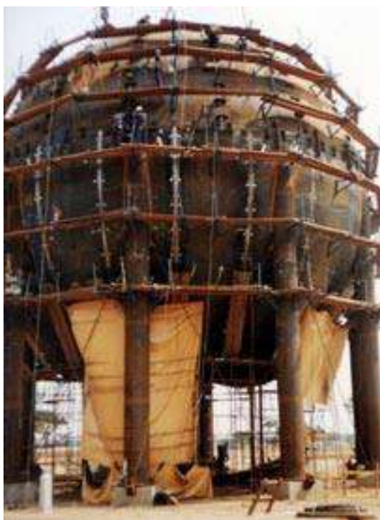
Figura 1.8 – Esfera de armazenagem
