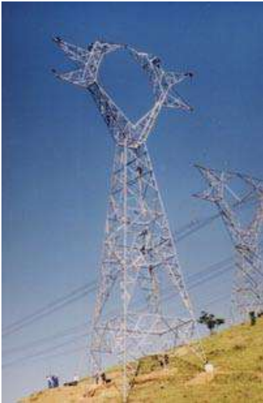
Figura 1.5 – Torre de transmissão de energia
